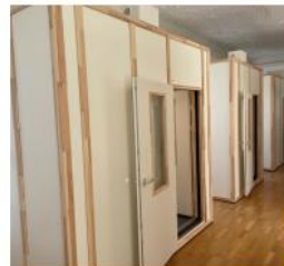
Die schalldichten Übungsboxen, angefertigt von einer Spezialfirma
